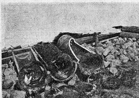
Фиг. 12. Прорастание корней деревьев в канализационные трубы.
